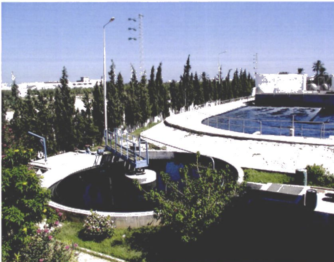
Station de prétraitement des eaux usées—Usine de Ksar Hellal
