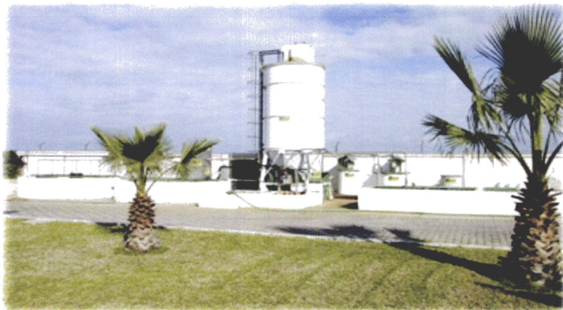
Station de traitement des eaux
